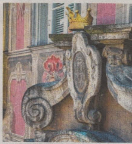
Verblasst: Die Fassade ist sanierungsbedürftig
